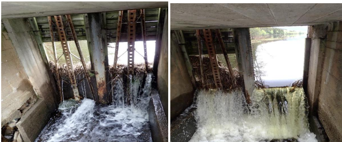
Flomfare ved tilstopping. Foto: Norconsult
