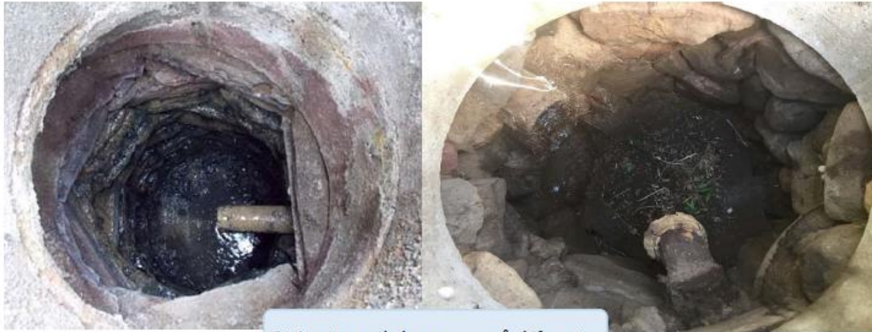
Steinsatte synkekummer – må skiftes ut
