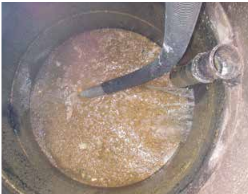
Betongkum med kumsatte ringer – ved tømning av slam, ser man at vann lekker inn i kummen fra omfyllingsmassene rundt kummen
