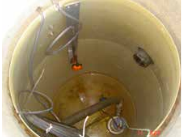
Pumpekum med vippestyrt pumpe og alarm for høyt vannnivå, samt krympeskjot på den elektriske tilkoblingen til pumpa. Kummen er tilfredsstillende
