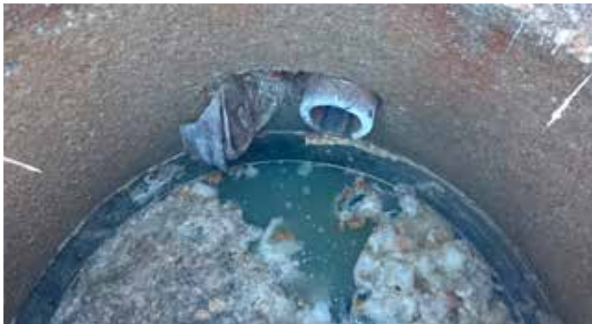
Glasert teglsteinsrør ledes inn i slamavskiller via kumgjennomføring som ikke er tett
