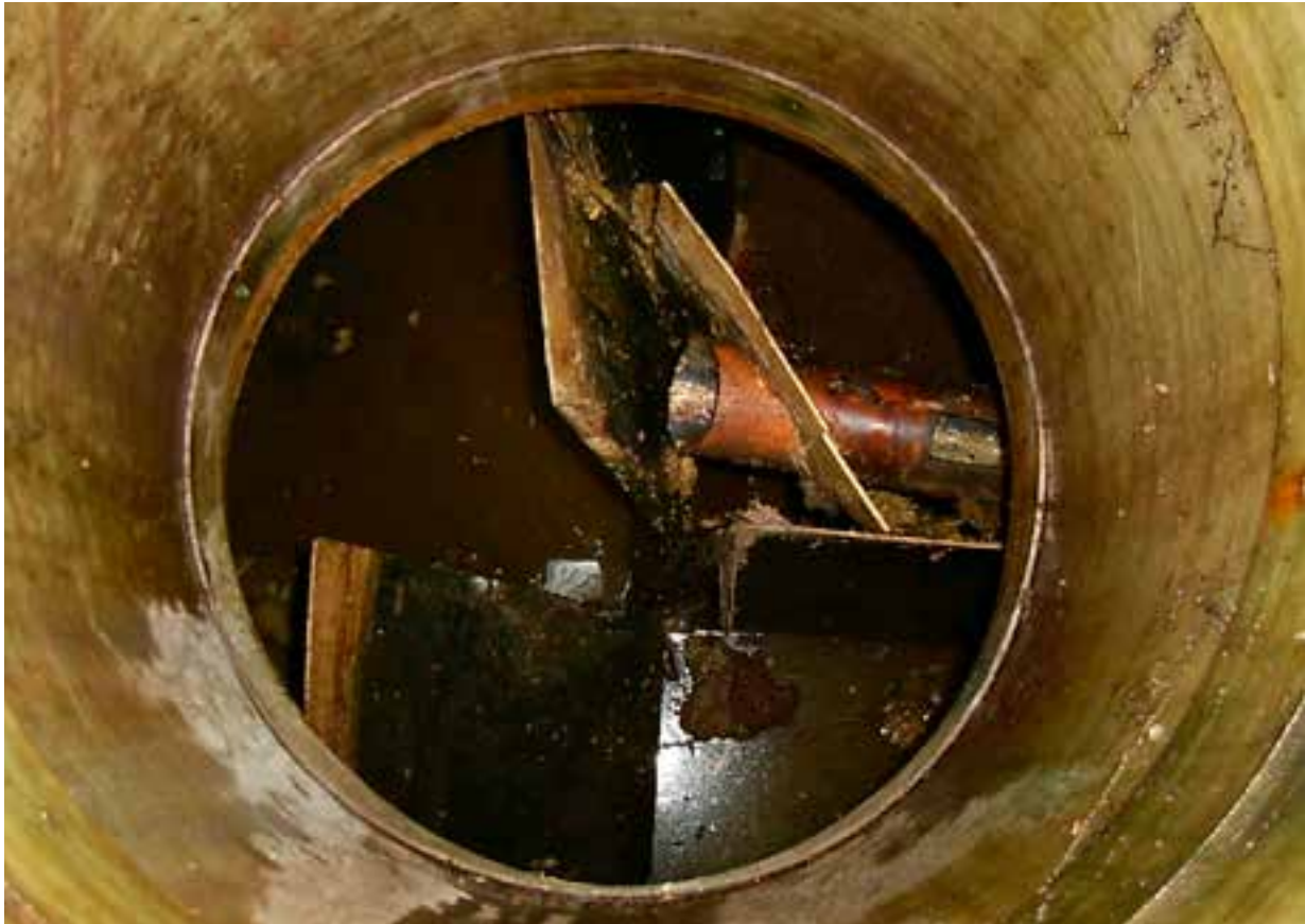
Glassfiber slamavskiller med ødelagte skillevegger, trolig grunnet skjevbelastning
