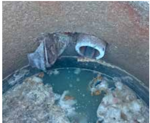
Kumgjennomføringen for avløpsrøret er ikke tett og annet rør ledes inn i kummen - fremmedvann tilføres slamavskilleren
