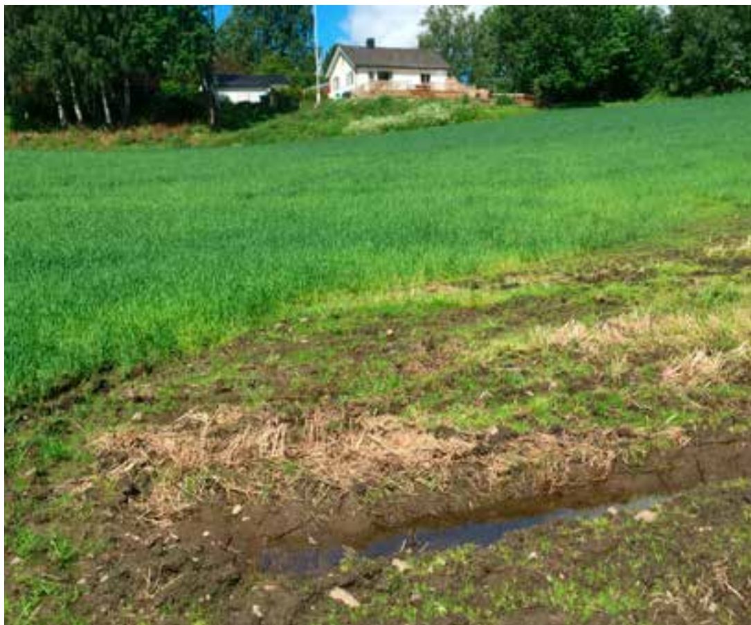
Vannutslag til terreng nedstrøms eldre infiltrasjonsanlegg med dårlig fordeling av avløpsvannet
