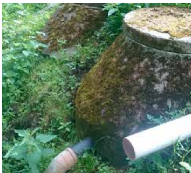
Eldre betongslamavskillere med utløp over bakkenivå – utsatt for frost
