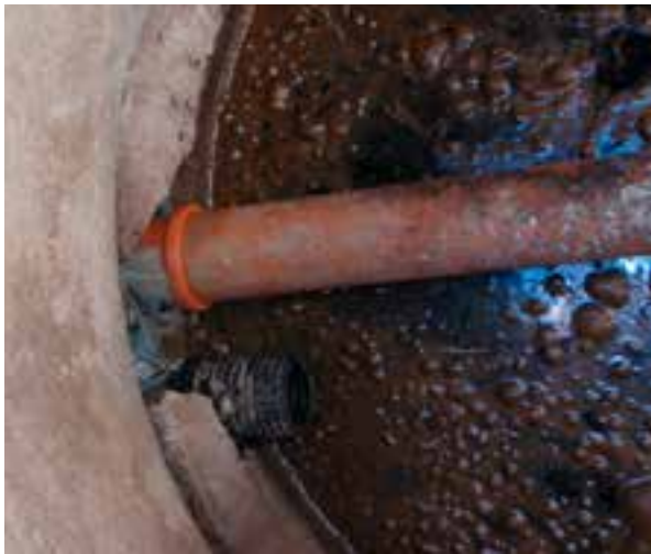
Drensrør ledes inn i kummen og kumgjennomføringen for avløpsrøret er ikke tett - fremmedvann tilføres slamavskilleren
