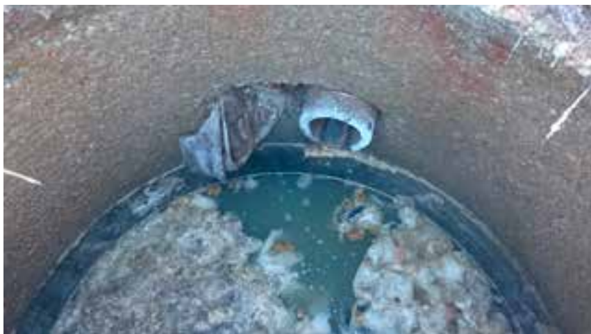
Glasert teglsteinsrør ledes inn i slamavskiller via kumgjennomføring som ikke er tett
