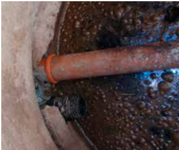
Drensrør ledes inn i kummen og kumgjennomføringen for avløpsrøret er ikke tett - fremmedvann tilføres slamavskilleren
