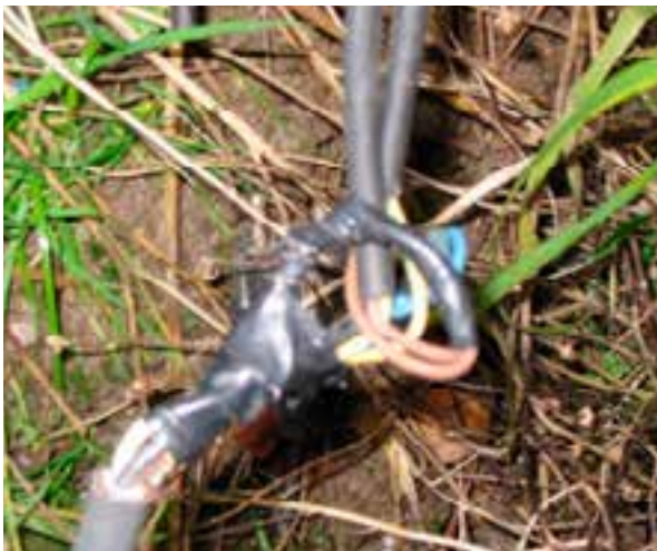
Elektriske koblinger må være forskriftsmessig utfør, og beskyttet mot fuktighet og gasser
