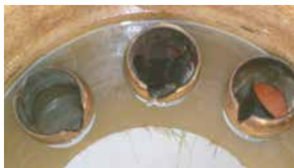
Fordelingskum med fastmonterte utløpsrør, som ikke ligger i samme nivå – gir ujevn fordeling. Kummen til venstre er også gjenslemmet, grunnet dårlig drift og vedlikehold gjennom mange år
