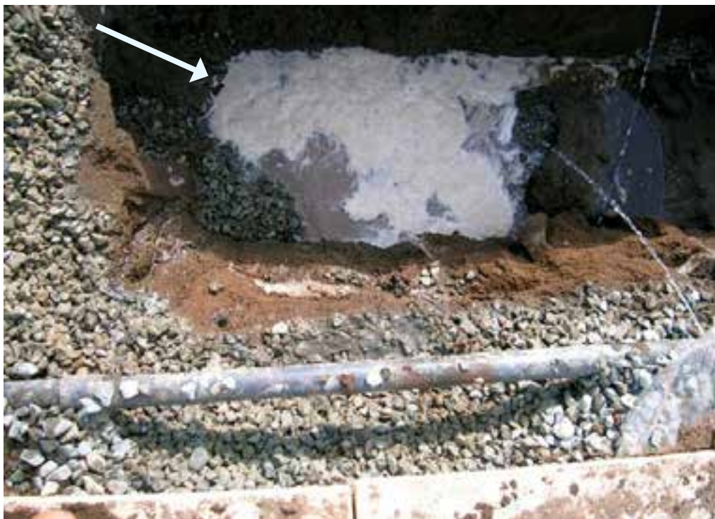
Oppgraving av lukket infiltrasjonsanlegg med kapasitetsproblemer. Pil viser grått belegg på filter- flaten, som resulterer i svært liten infiltrasjonskapasitet. Det er benyttet uvasket pukk, og det grå belegget et steinmel som er vasket ut av fordelingslaget.
