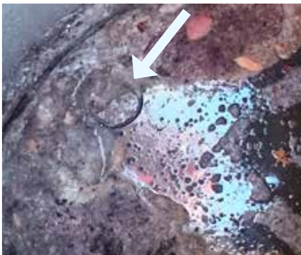
Utløpet er tett slik at vannivå har steget over dykker på utløp. Dette kan skyldes tett infiltrasjonsgrøft, frost eller annet.
