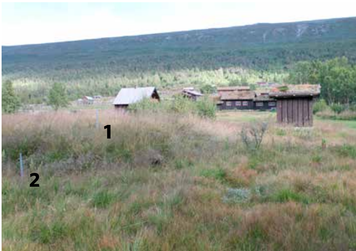
Peilerør satt ned til filterflaten i et jordhauginfiltrasjonsanlegg (1) og til grunnvannet (2). Støtbelaster / pumpestasjon til høyre i bildet.
