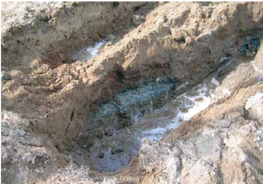
Overbelastet lukket infiltrasjonsanlegg for 450 pe. Oppgraving med gravemaskin viser at hele fordelingslaget er vannmettet med avløpsvann.
