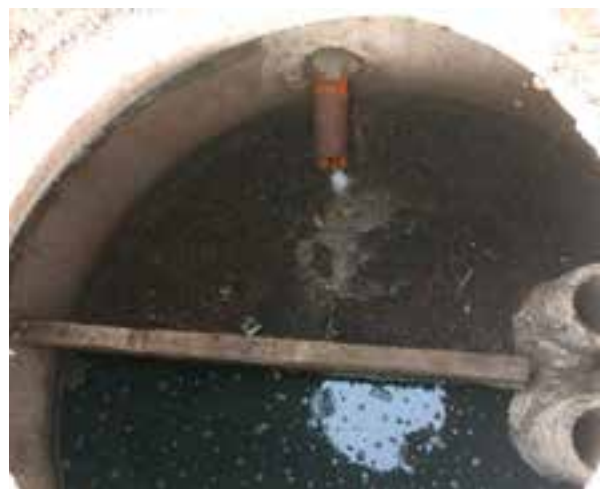
Plastrør inn i slamavskiller via kumgjennomføring som trolig ikke er tett
