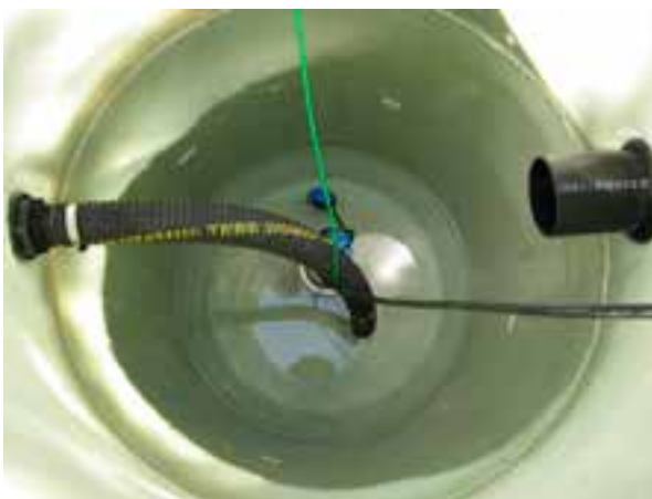
Pumpekum med vippestyrt pumpe – mangler alarm for høyt vannnivå, ellers ok
