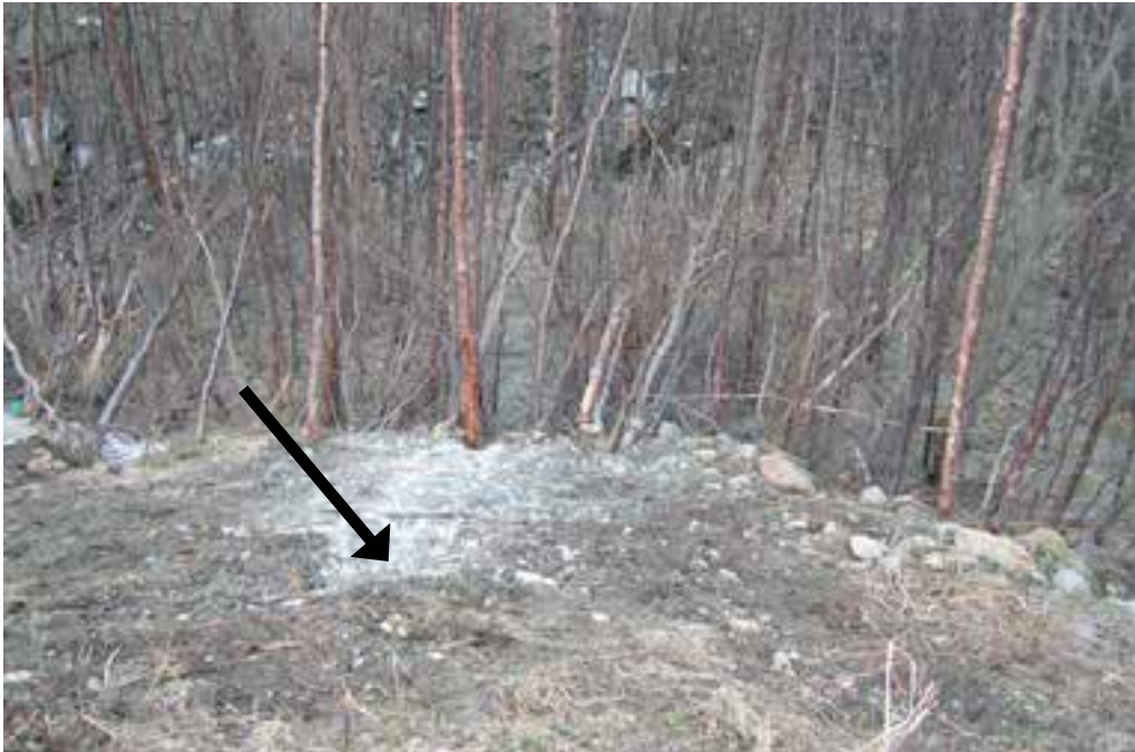
Vannutslag av urensset avløpsvann i kanten av et lukket infiltrasjonsanlegg for 600 pe. Pil viser soppdannelser ved utslaget og et stykke nedover skråningskanten.
