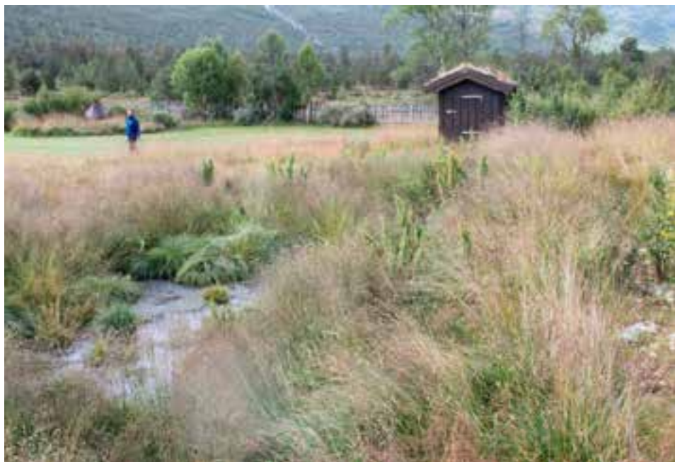
Utslag av avløpsvann nedstrøms et jordhauginfiltrasjonsanlegg for en turisthytte. Infiltrasjonsanlegg til høyre i bildet, støtbelaster/pumpestasjon i bakgrunnen.
