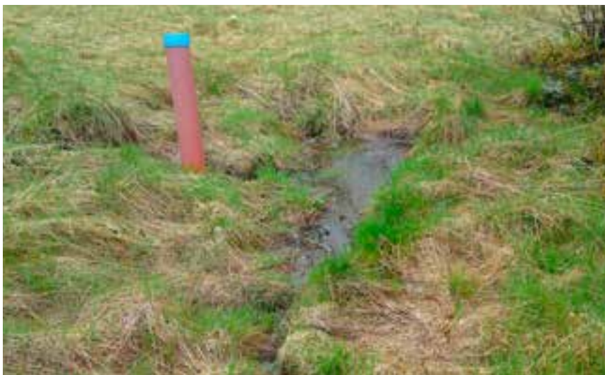
Feilprosjektert infiltrasjonsfilter etablert i for tette jordmasser medfører at grunnvannet står over infiltrasjonsfilteret. Slamavskilt avløpsvann ledes direkte ut som overflatevann.
