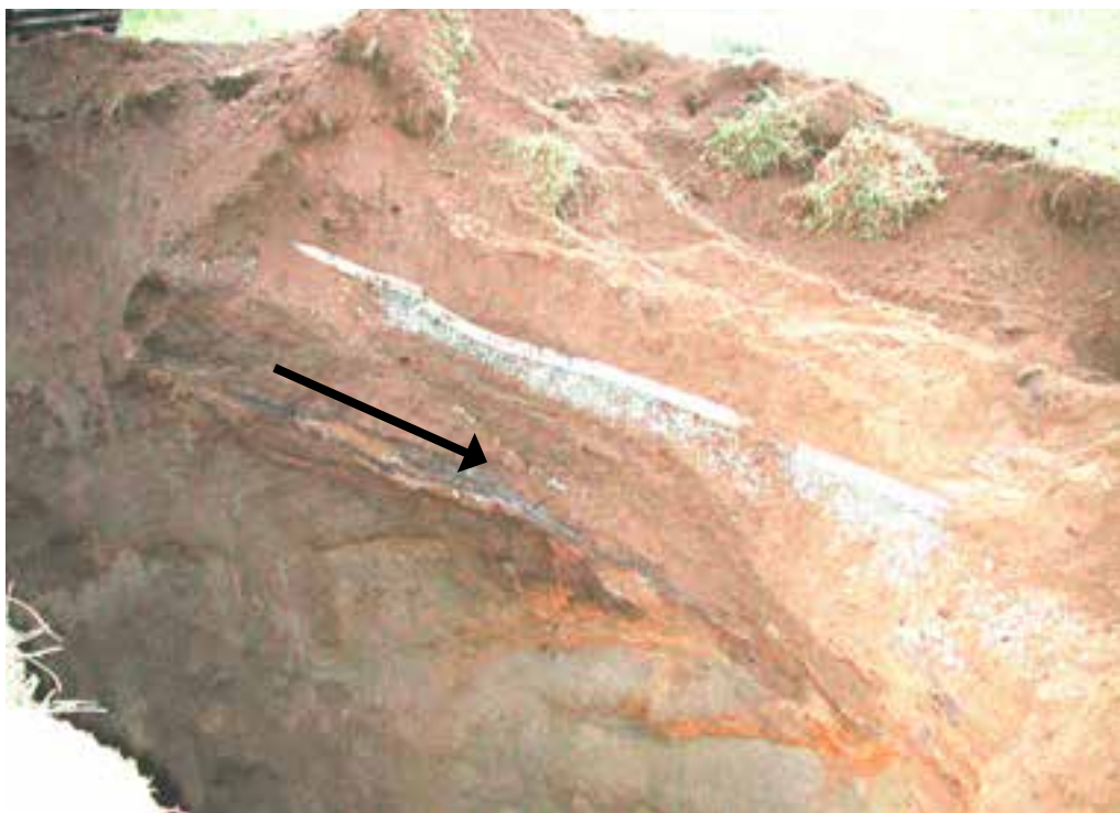
Oppgraving av lukket infiltrasjonsanlegg med kapasitetsproblemer. Pil viser tette lag med aurhelle (jærutfelling) under fordelingslaget med pukk, som hindrer infiltrasjon av avløpsvann.
