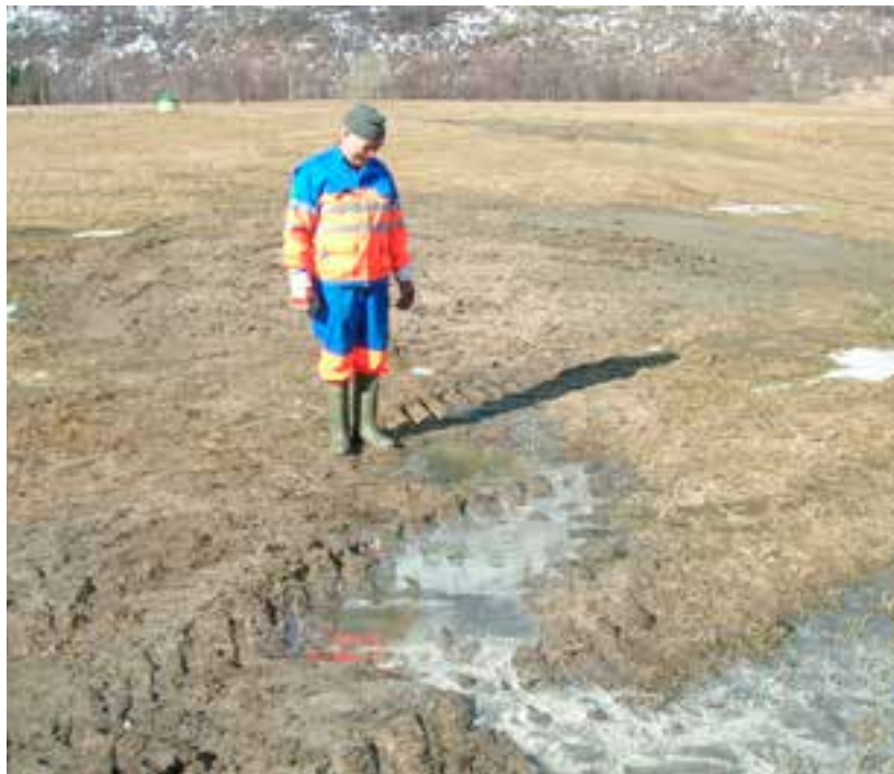
Vannutslag av urensset avløpsvann rett nedstrøms et lukket infiltrasjonsanlegg for 450 pe, med filterflate på 2 x 850 m 2 . Vannutslaget skyldes en kombinasjon av dårlig fordeling av avløpsvann, samt en skrånende bassengbunn som heller ned mot tette silt- og leirelag.
