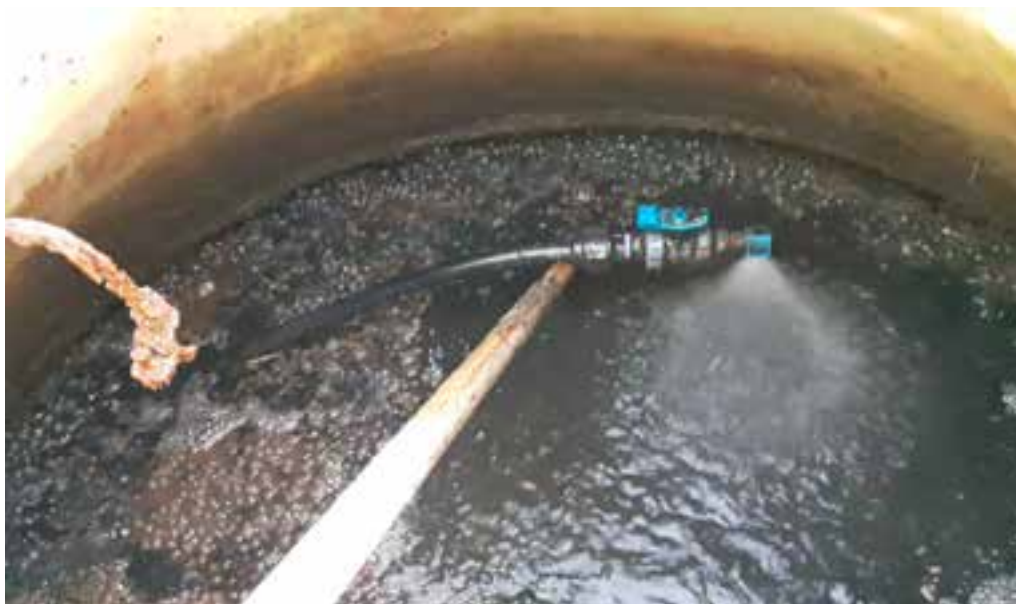
Lukket infiltrasjonsanlegg for 100 pe med forbehandling i 20 filterkummer, med dysespredning av avløpsvannet. Hele filteret er vannmettet grunnet gjentetting av filterflaten under filterkummene.
