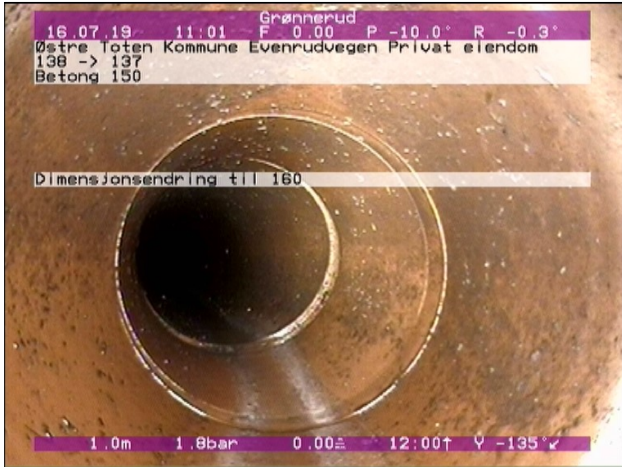
Foto: 5_1_3_16072019_105608_A.JPG 1m, Dimensjonsendring til 160
